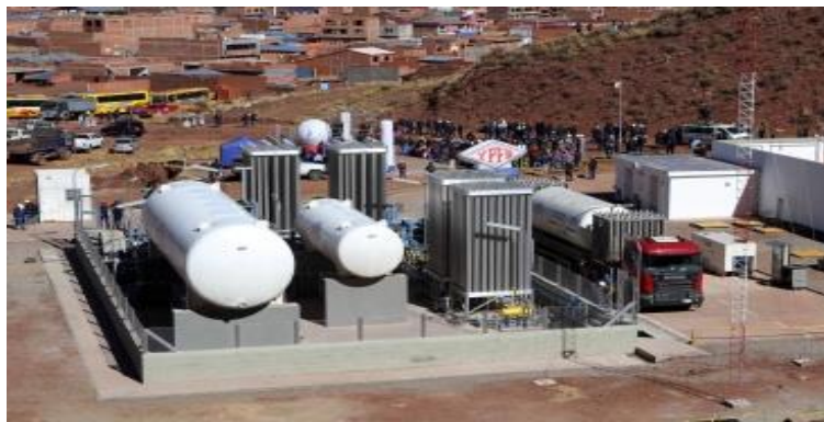
Figura 7. Estación Satelital de Regasificación
