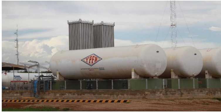
Figura 10. Almacenamiento de GNL en ESR
