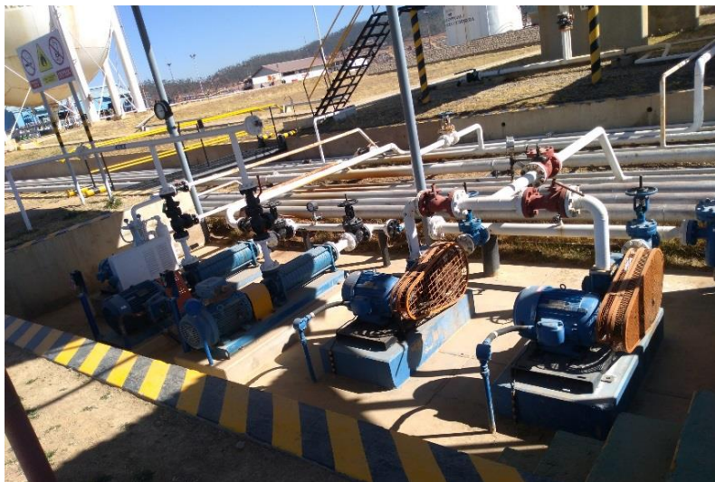
Figura No 22: Compresor para trasvase de GLP en camiones
