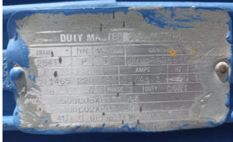
Figura No 26: Fotografía de la placa del motor
