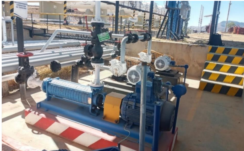
Figura No 25: Bombas multietapas para el trasvase de GLP
