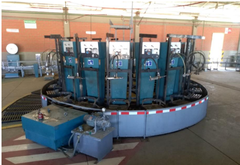
Figura No 29: Carrusel de llenado de GLP
