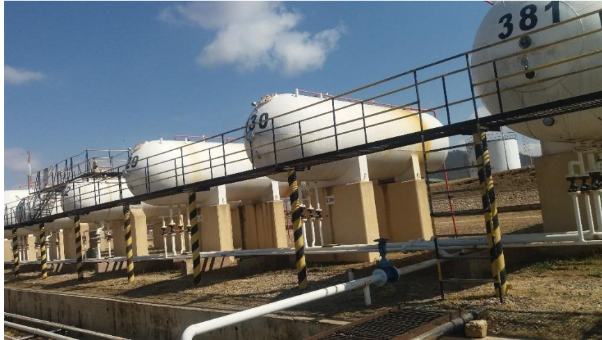
Figura No 23: Tanques horizontales de GLP
