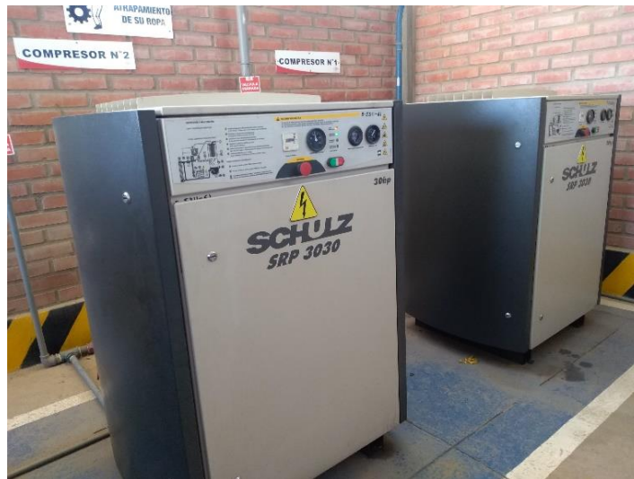
Figura No 27: Compresores de aire
