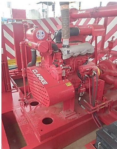
Figura No 31: Bomba principal contra incendios
