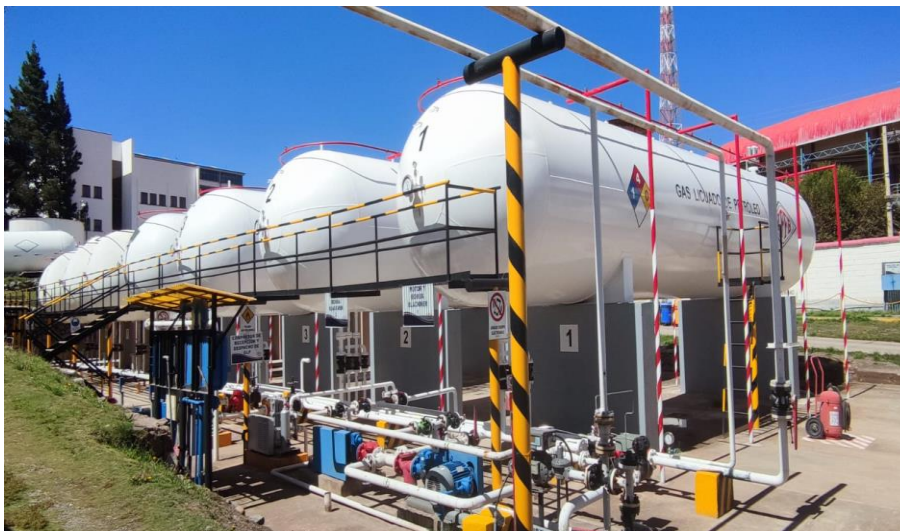
Figura 11 Tanques de almacenamiento de GLP
