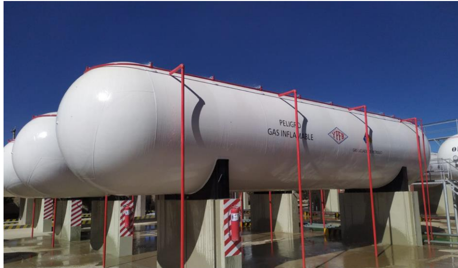
Figura 1 Tanques de almacenamiento
