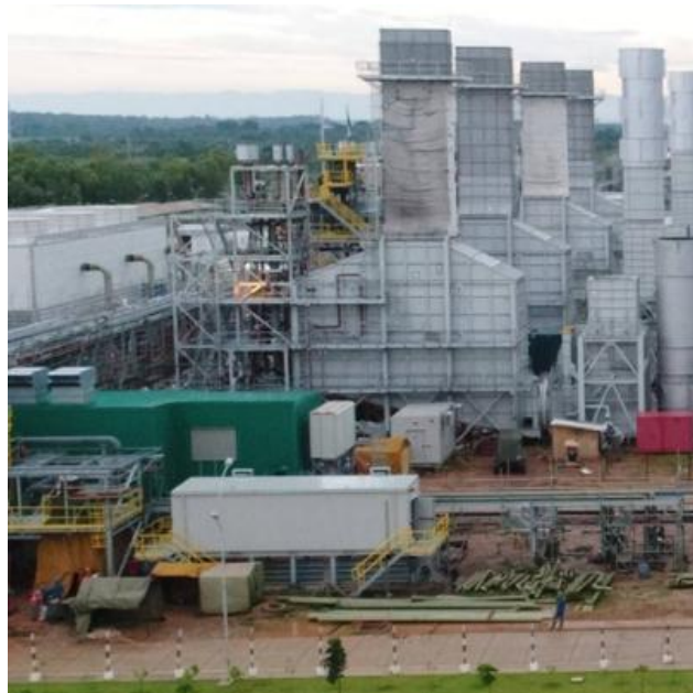
Figura 2.23: Turbinas de la Termoeléctrica de Warnes
