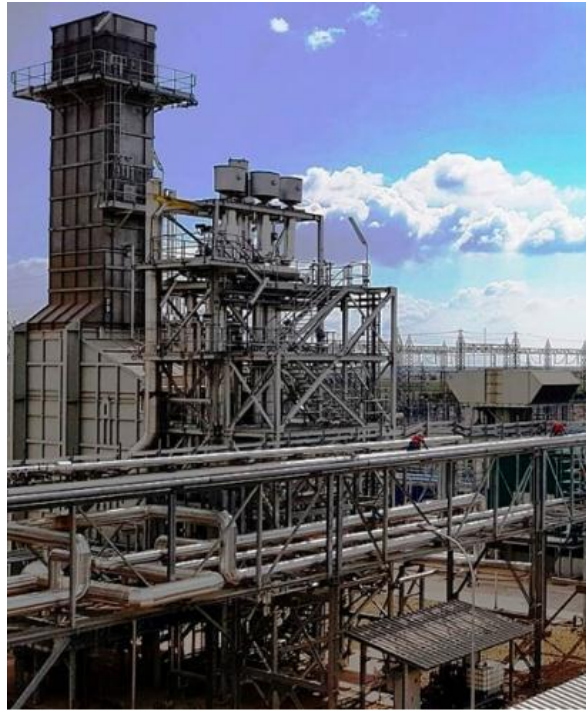
Figura 2.22: Vista Lateral de la Termoeléctrica de Warnes
