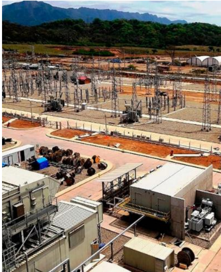
Figura 2.24: Vista de la Subestación
