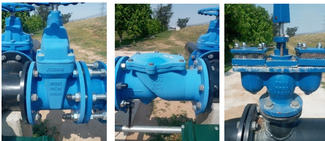
Figura 2.26: Valvulería en el Ramal de Explotación de Agua
