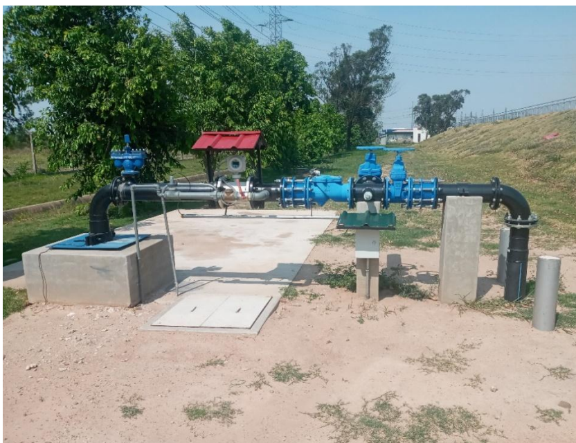
Figura 2.25: Pozo para la Extracción de Agua
