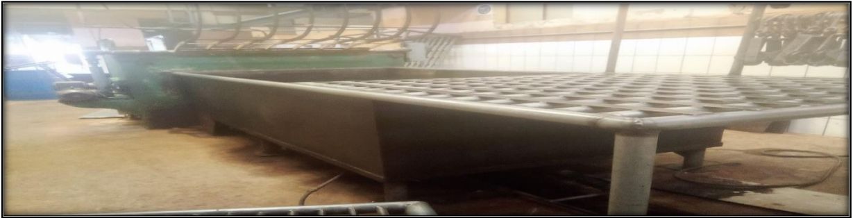
Caldera de proceso de escaldado
