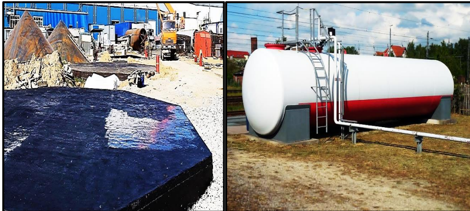
Figura 5: Características de instalación de los tanques de combustibles.
