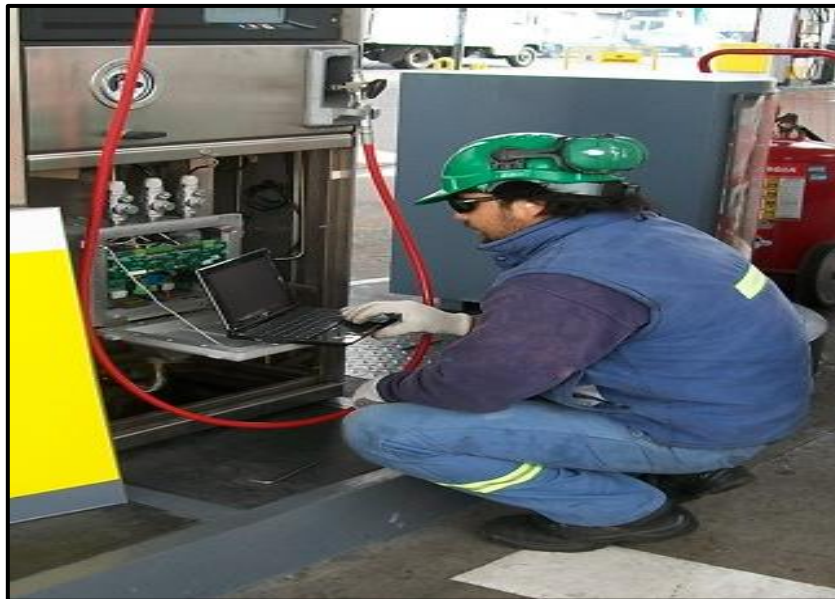
Figura 15: Mantenimiento a estaciones de servicios.
