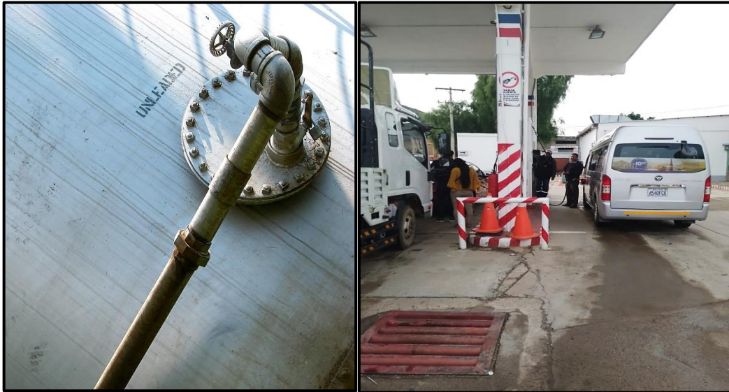
Figura 12: Sistema de purga en la estación la Estación De Servicio El Tejar.
