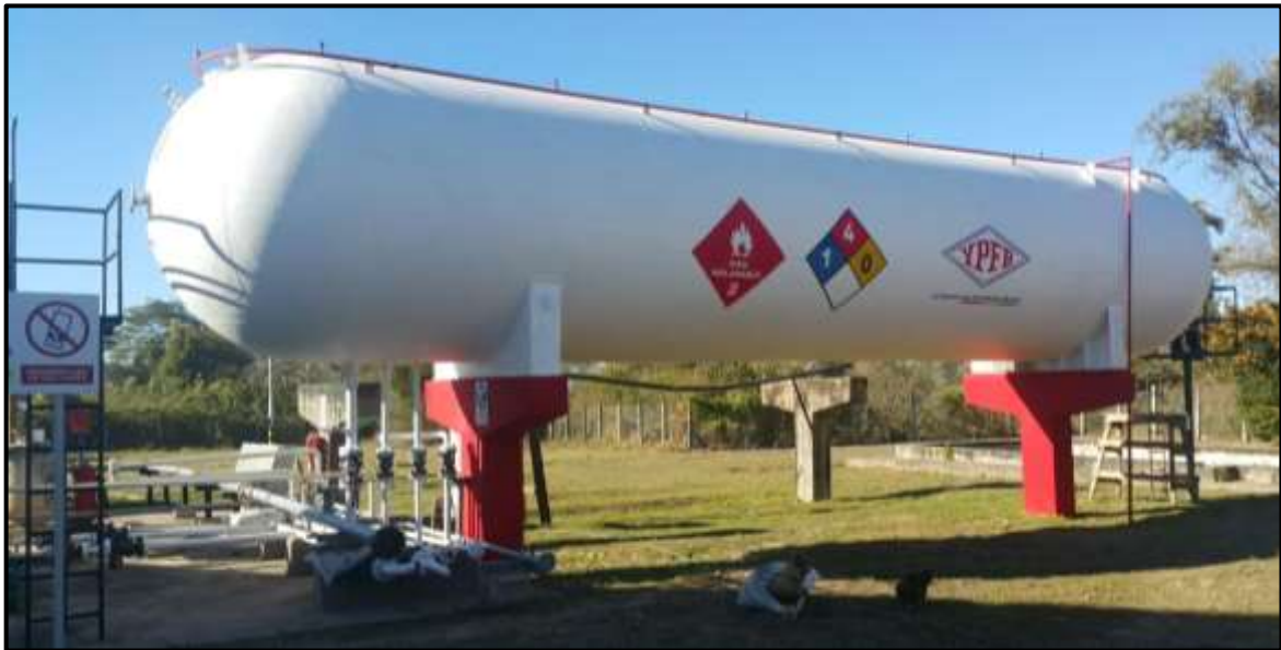
Figura 11: Tanque de almacenamiento de GLP.
