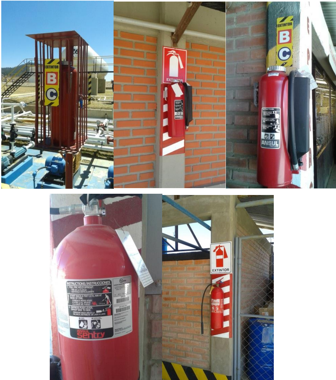
Figura N° 15 Extintores en la Planta
