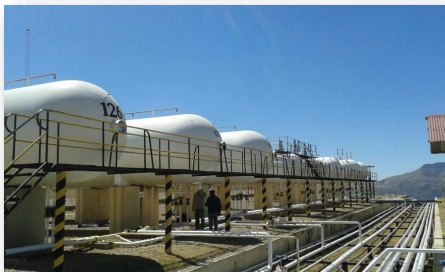
Figura N° 13 Sector de Tanques Horizontales
