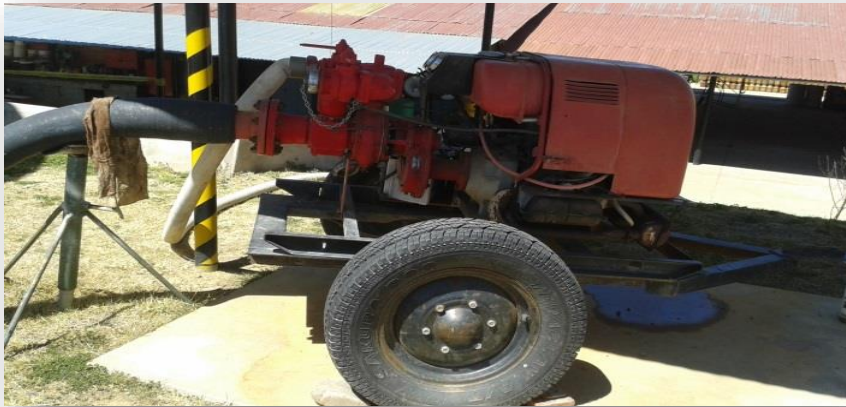
Figura N° 17 Zona de La Bombas Portátil
