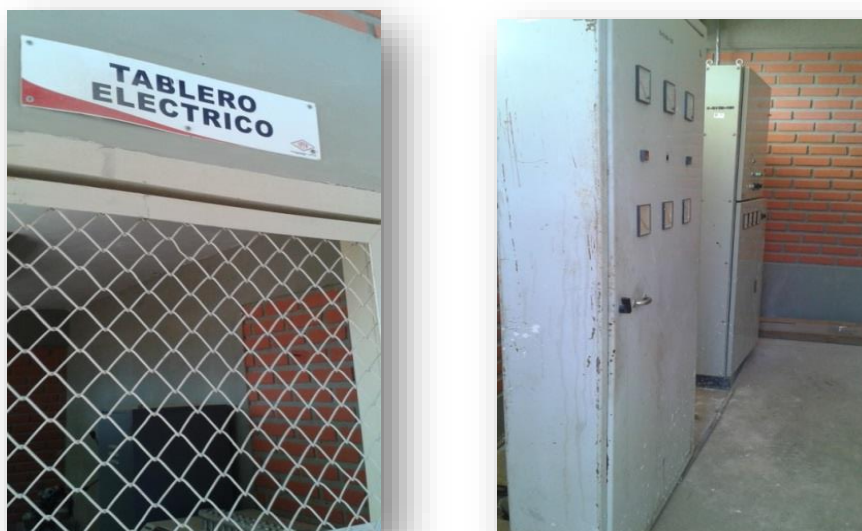
Figura N° 20 Sala de Tableros Eléctricos
