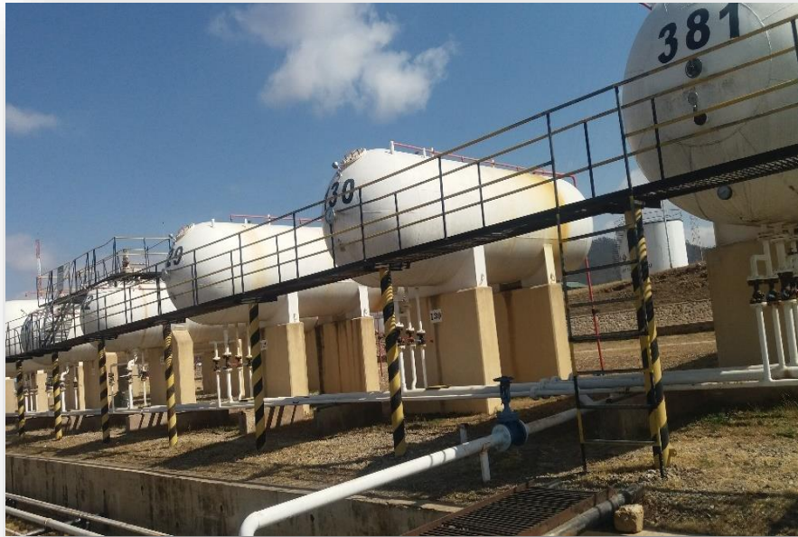
Figura N° 5 Tanques Horizontales de GLP
