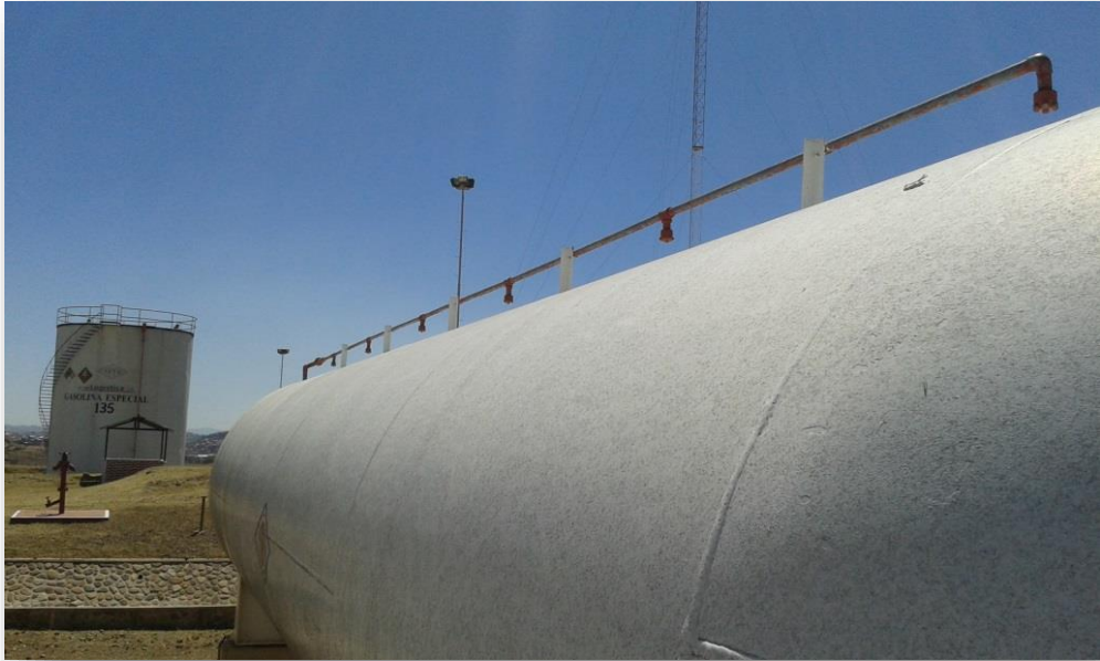
Figura N° 14 Sector de Tanques Horizontales (Vista Rociadores)
