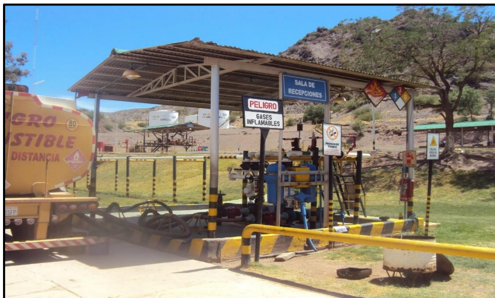
Figura 8: Sala de recepción de combustible planta Tupiza
