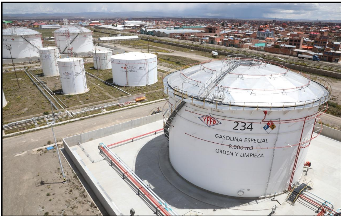
Figura 2: Tanque de almacenamiento de combustibles líquidos.
