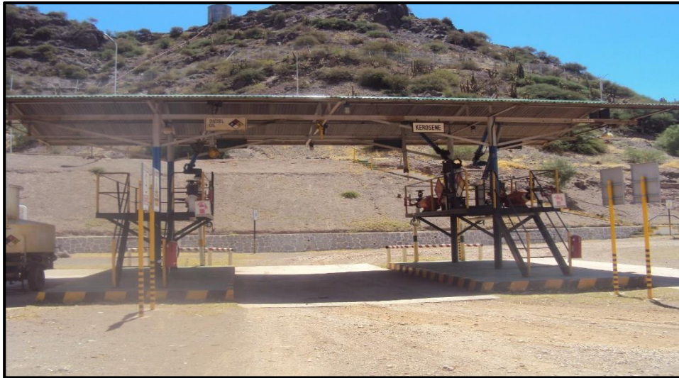
Figura 10: Sala de despacho de combustible
