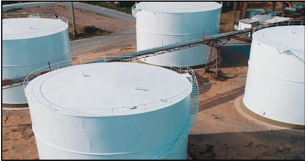
Figura 3: Tanques de almacenamiento techo fijo según API 65
