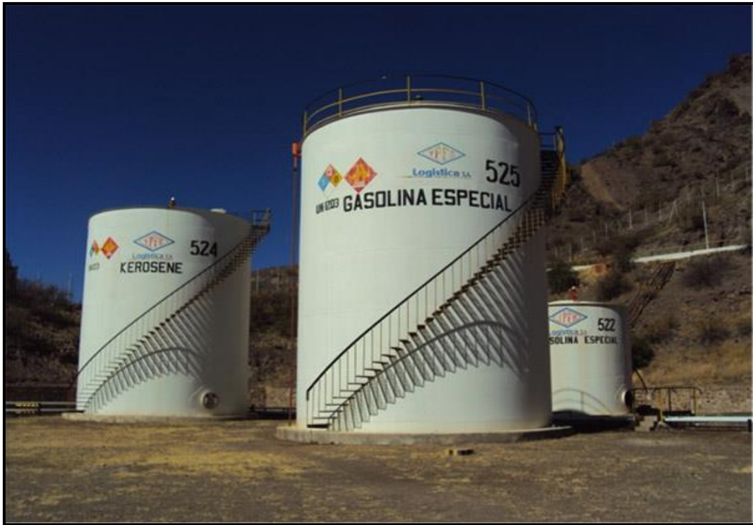
Figura 9: Área de tanques de almacenamiento en planta Tupiza
