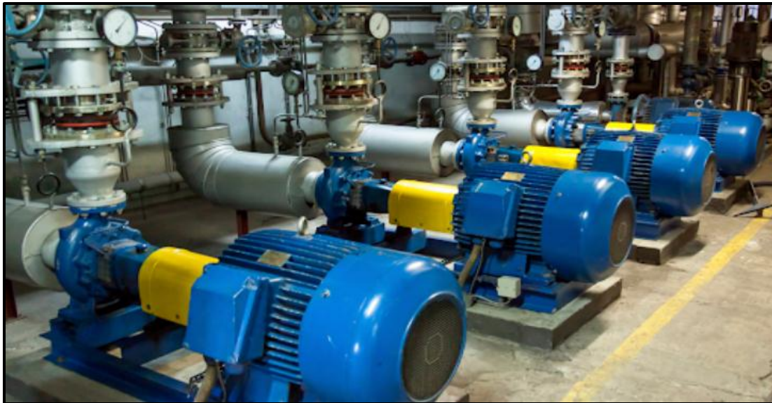
Figura 2: Bombas en la Estación de Bombeo
