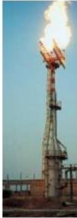
Figura 2-0-10 Flare multipunto en posición elevada
