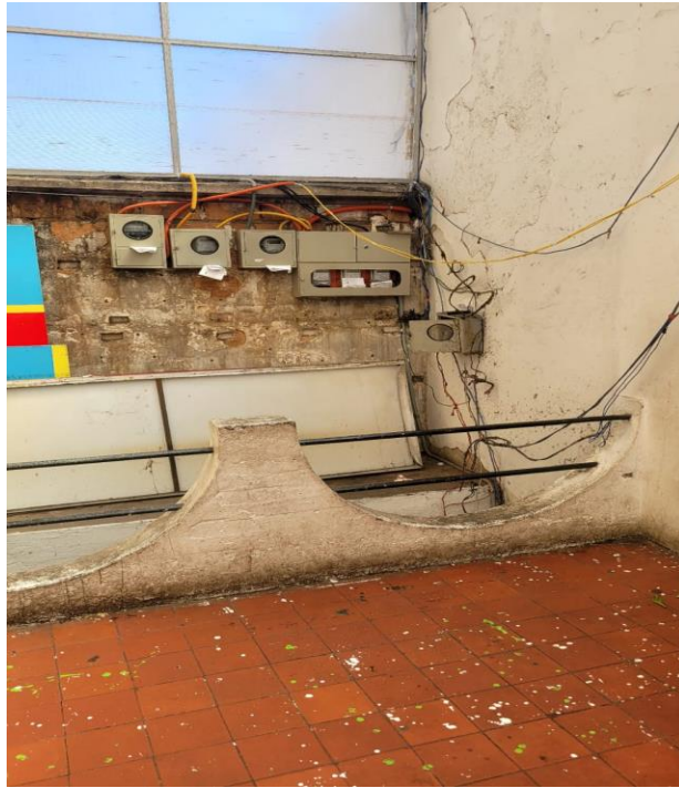
Nota: instalaciones eléctricas al aire libre sin protección ni señalización. Fuente: Ph. (Janeth Nuñez, 2024).
