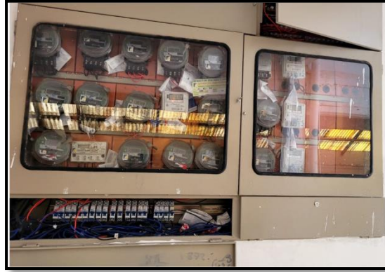
Ilustración 3: Panel de medidores Mercado central de Sucre
