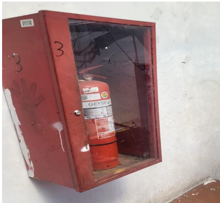
Nota: Extintor sin mantenimiento ni señalización. Fuente: Ph. (Janeth Nuñez, 2024).
