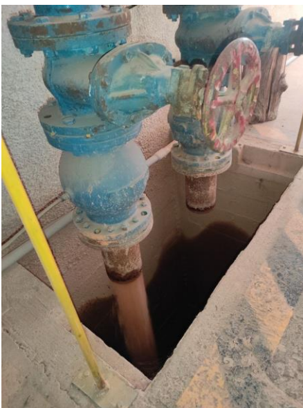
Ilustración 4 Extractores de fangos
