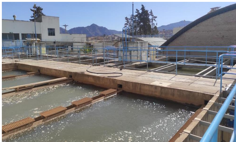
Ilustración 3 Decantadores de la PTAP El Rollo
