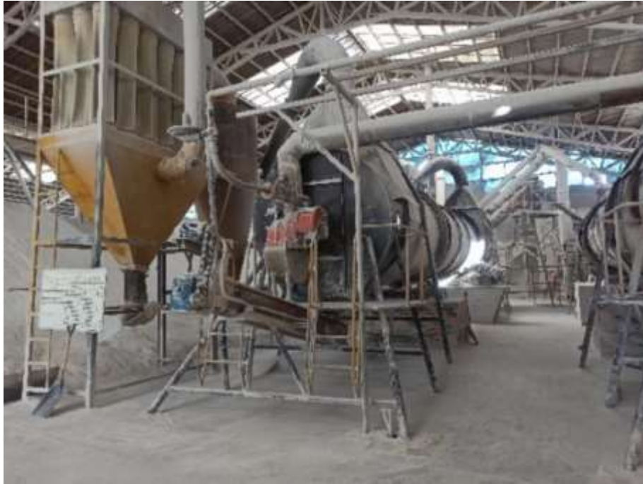
Figura A-5: Área de Calcinación de la planta Fuente: SOCCOMAVK S.C.
