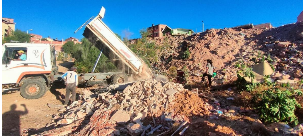
Fotografía 17: Empresa transportadora de Ecombros después de la Demolición de Infraestructura – Buzón Buzón Patacón 1
