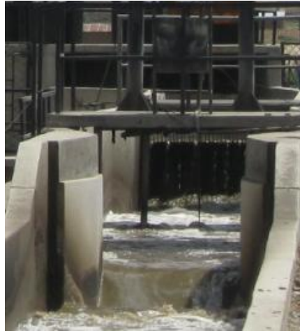
Figura 1.30: Parshall al ingreso a la Planta de Puchukollo.
