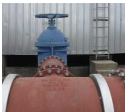
Figura 1.36: Válvula de alimentación del filtro – Puchukollo.
