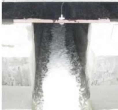
Efluente del Filtro Percolador
