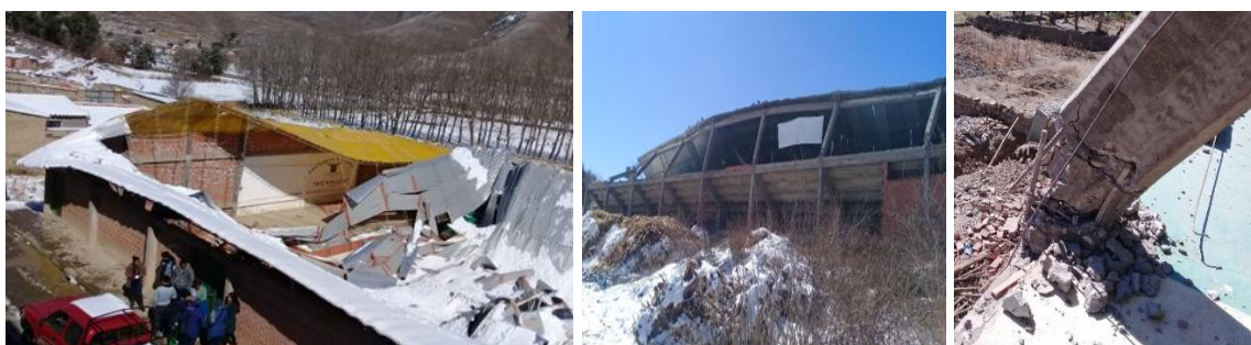
Figura 2.5. Tinglado caído por malos diseños estructurales, Municipio Incahuasi, Chuquisaca 2019; (imagen izquierda) muestra el colapso de la cubierta, (imagen central) colapso de las columnas y (imagen derecha) muestra el fallo de la armadura por el empalme de la armadura de las columnas (Elaboración propia).
