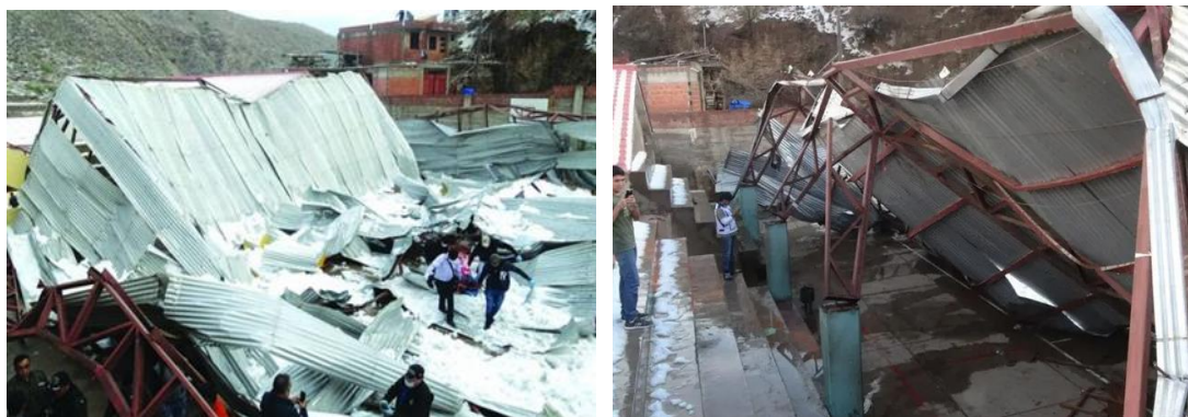
Figura 2.10. Imágenes del colapso cubiertas metálicas en la ciudad de Sucre (Correo Del Sur 2021)
